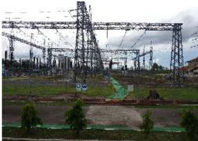
Gambar 1. Unit pelayanan Transmisi UPT Sulselrabar Transmisi dan Gardu Induk Bulukumba
