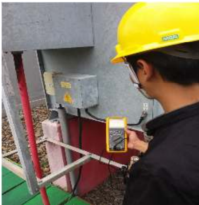
Gambar 3. Pengukuran I_N (Arus Netral)
