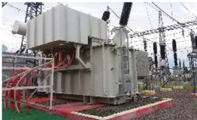
Gambar 2. Transfrmator 20MVA GI Bulukumba
