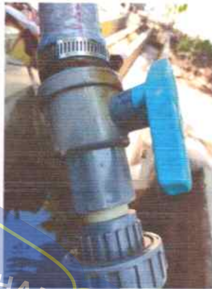
kran pipa untuk pengaliran
