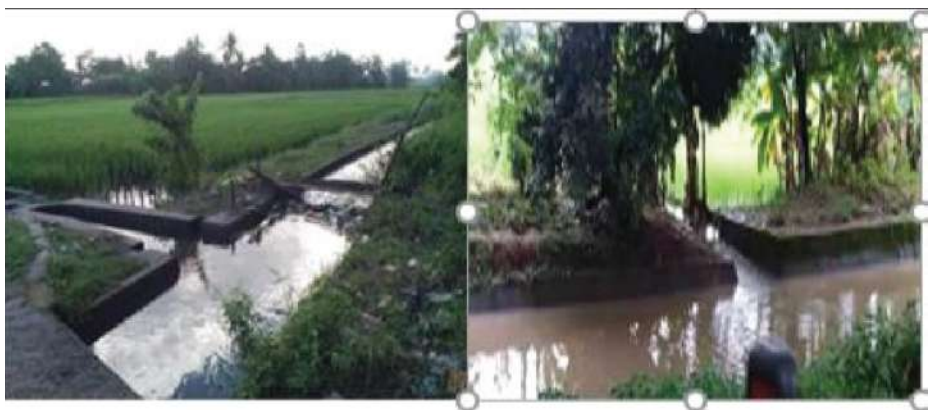
Gambar 13. Saluran Tersier Tanpa Pintu
