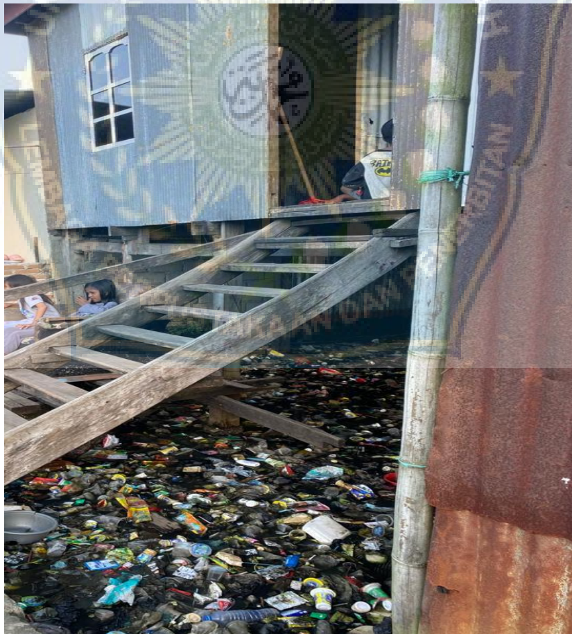
Salah satu Rumah yang berada di Permukiman Kumuh
