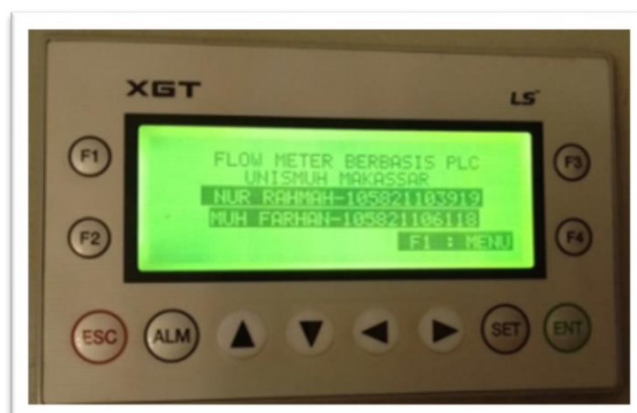
Gambar 4.3 Tampilan HMI pada panel box
