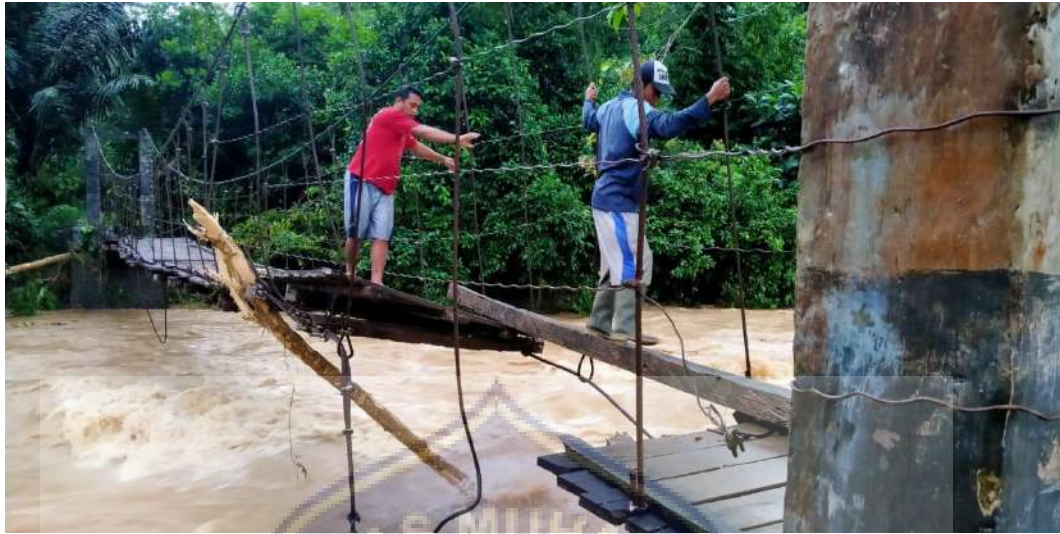
Gambar 1. Kondisi jembatan rusak akibat banjir yang terjadi di Kabupaten Bulukumba, Provinsi Sulawesi Selatan, per Jumat (9/7) pukul 06.00 WIB. (BPBD Kabupaten Bulukumba)
