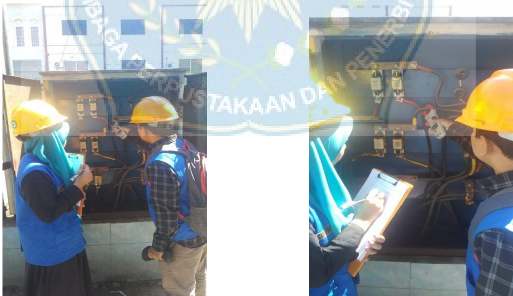
Gambar 6L: Dokumentasi Pengambilan Data Trafo Pada Siang Hari
