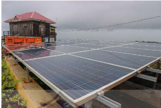
Gambar 27. Panel Surya di Pulau Camba Cambang Sumber : hasil observasi, 2023
