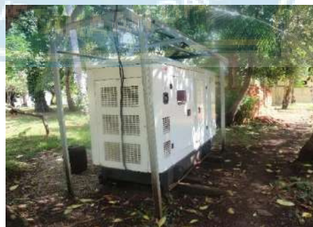
Gambar 19. Genset Sumber Listrik Pulau Dutungan Sumber : Dokumentasi Pribadi, 2023
