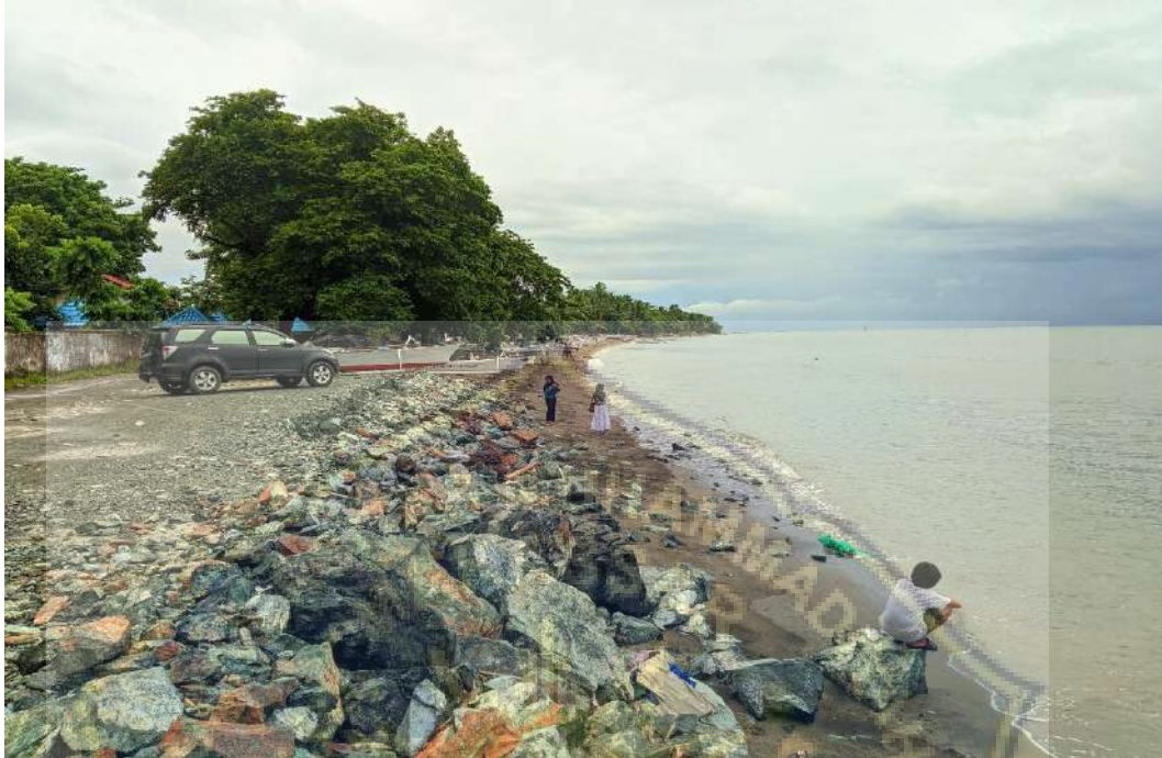
Gambar 40 : Abrasi yang terjadi di Pantai Ujung Batu
