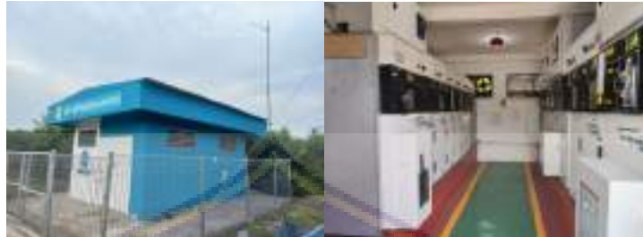
Gambar 2.19 Gardu hubung Sumber : Dokumen Pribadi
