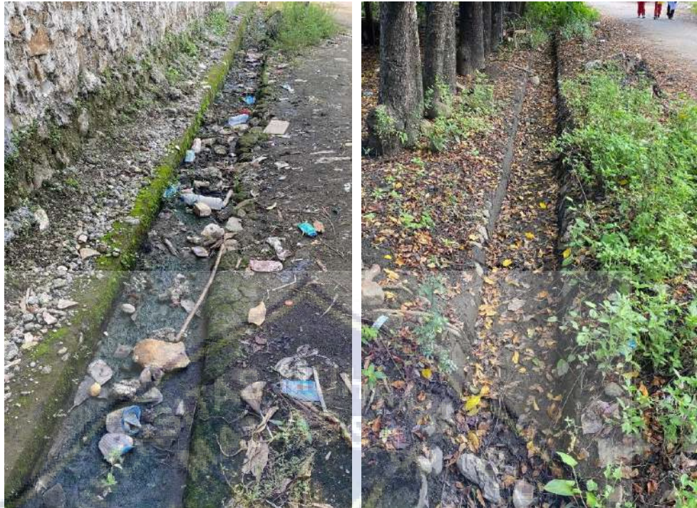
Gambar 24 Kondisi Fisik Drainase Sumber : Survey Lapangan, 2024
