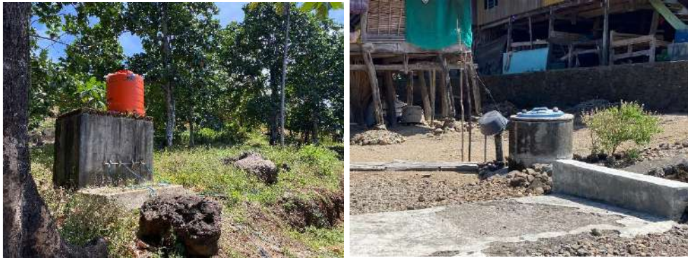
Gambar 21 Prasarana Air Bersih di Kecamatan Bangkala Sumber : Survey Lapangan, 2024
