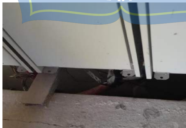
Gambar 3.4 Kerusakan Pada ujung Mop Kabel
