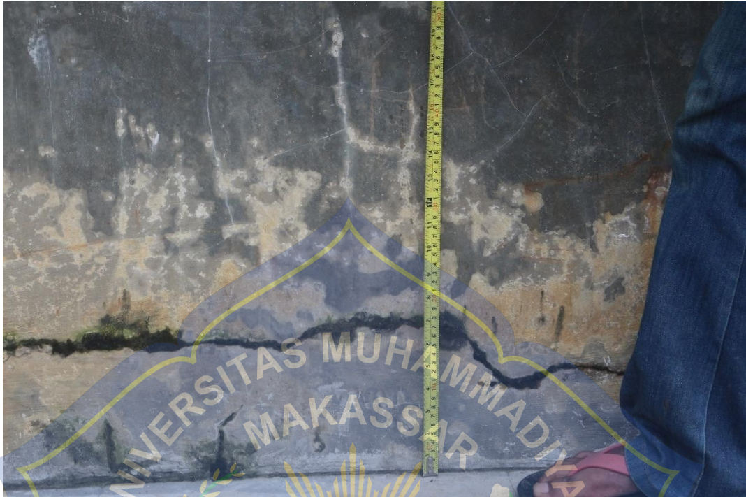
Gambar Bekas banjir pada dinding rumah warga
