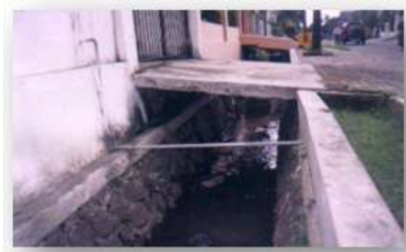
Gambar 10.2: Saluran Drainase Konvensional
