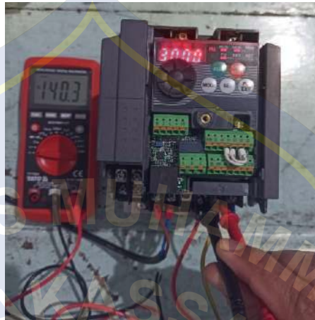
Gambar 4.7. Pengukuran Tegangan Output VFD
