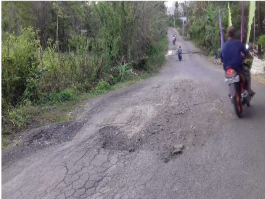
JALANAN RUSAK DI DESA TOMPO
