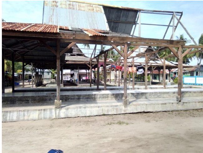
Gambar 4.13 Kondisi Bangunan di Pasar lama Kecamatan Pasimarannu
