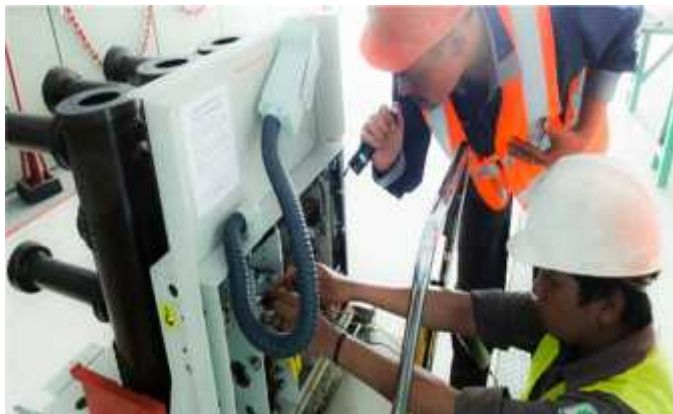
PERBAIKAN PANEL TRAFU 3 FASHA
