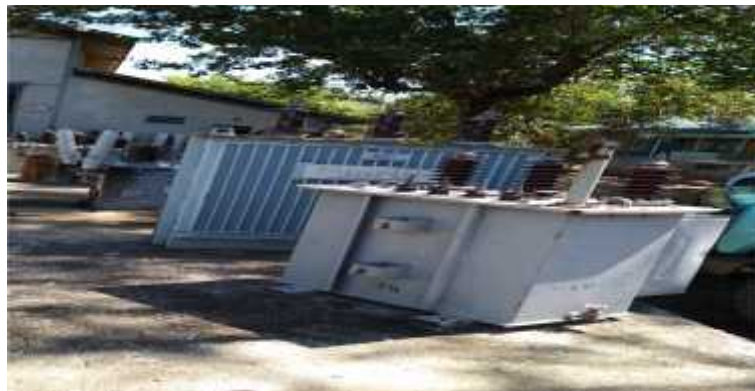
Trafo cadangan PLN rayon jenepono
