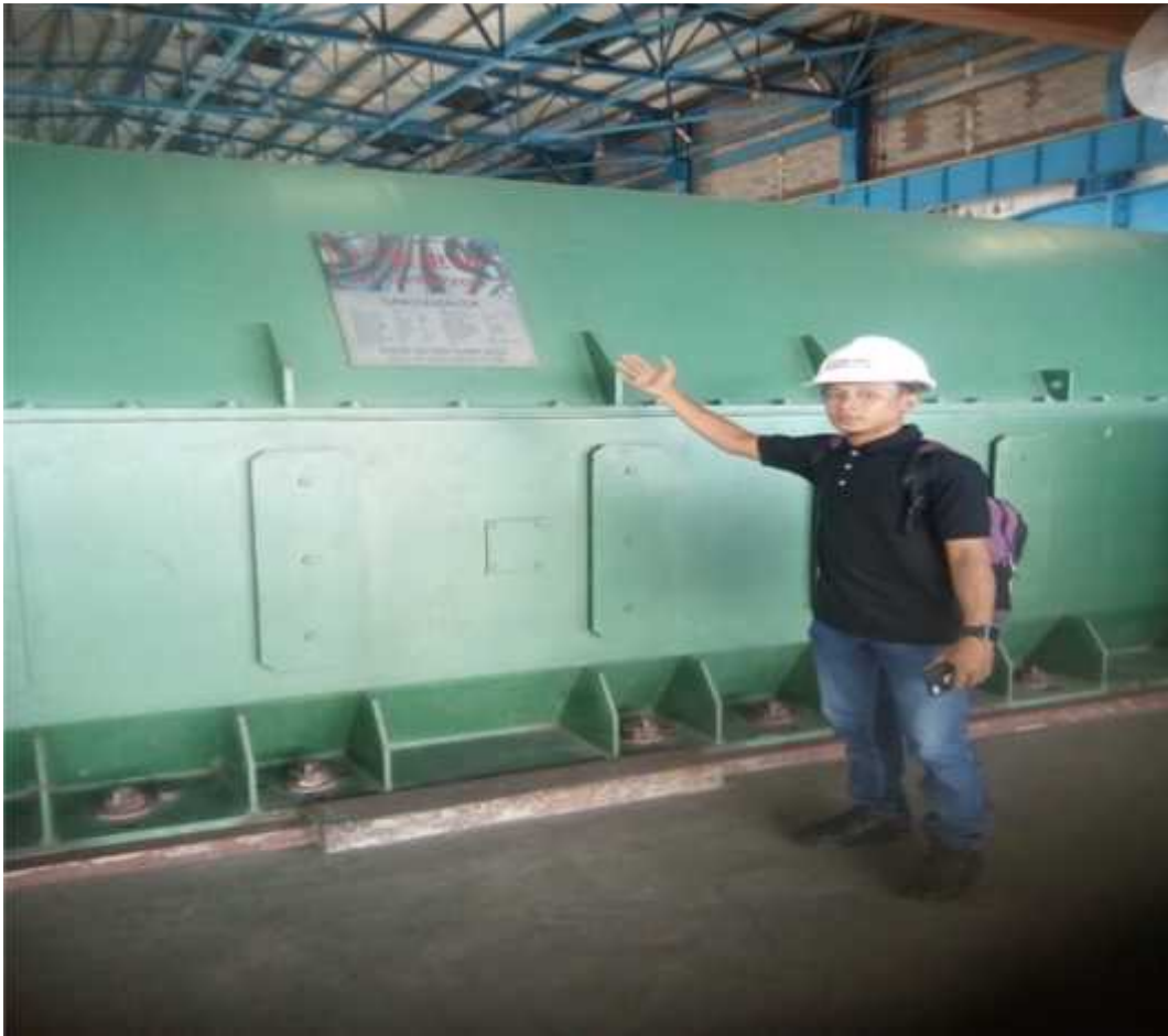
Generator PLTU Jeneponto
