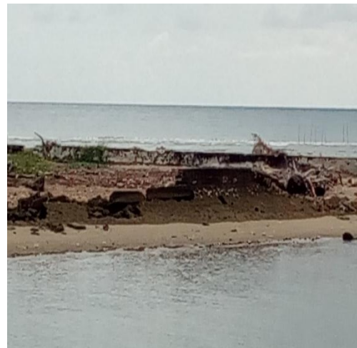
Kerusakan Bangunan Pelindung Akibat Abrasi yang Terjadi
