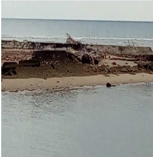
Kerusakan Bangunan Pelindung Gelombang
