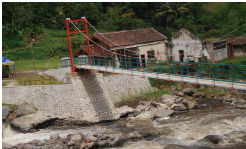
Gambar 6. Dasar pondasi jembatan gantung mulai tergerus oleh aliran sungai (Dimas Dewandaru, 2013)
