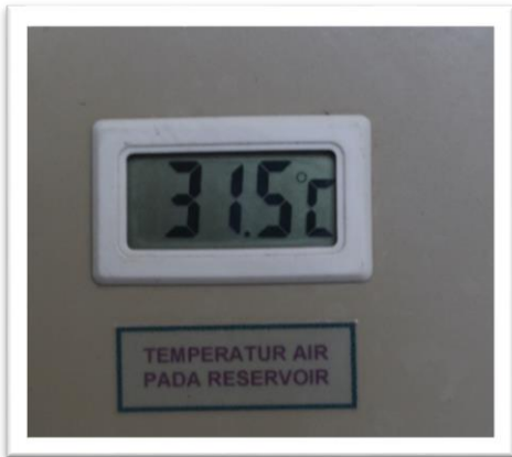
Pembacaan Suhu dan Tinggi Air Pada Reservoir
