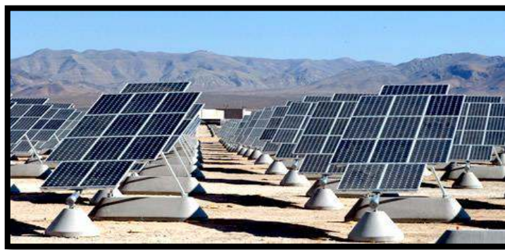
Gambar 2.4 Pembangkit Listrik Bertenaga Surya (PLTS)
