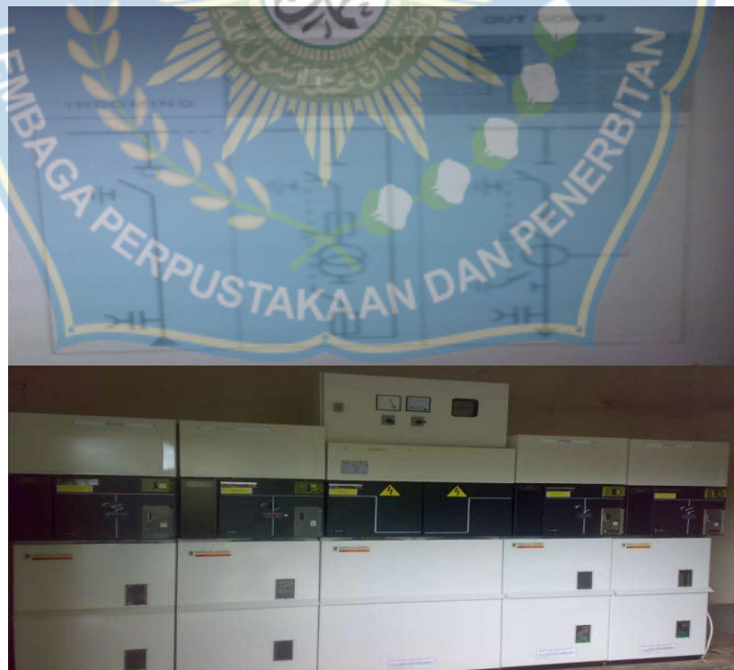
Gambar 2.22 PHB Tegangan Menengah (Hamma, Agussalim. 2012)
