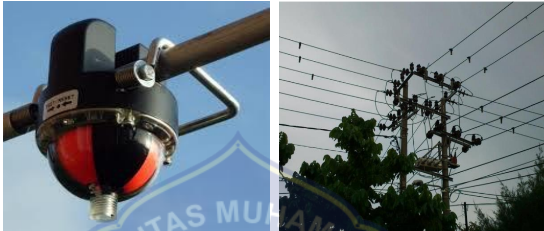
Gambar 2.6 Fault Indikator yang telah terpasang
