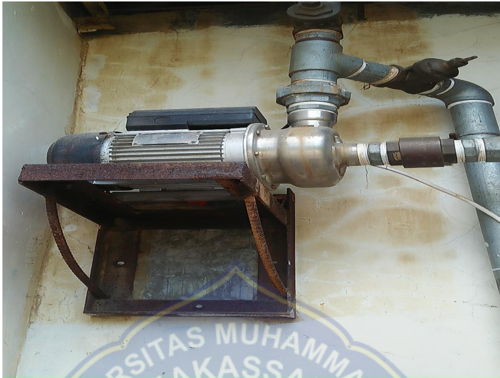
Pompa di air di Gedung Iqra
