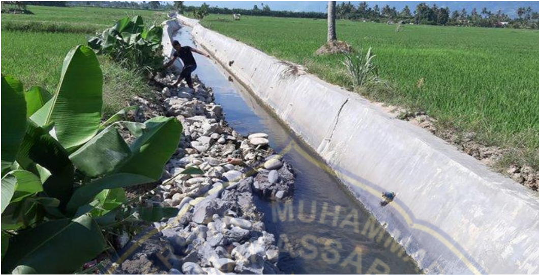
Gambar 3 : Kerusakan Pada Saluran Irigasi
