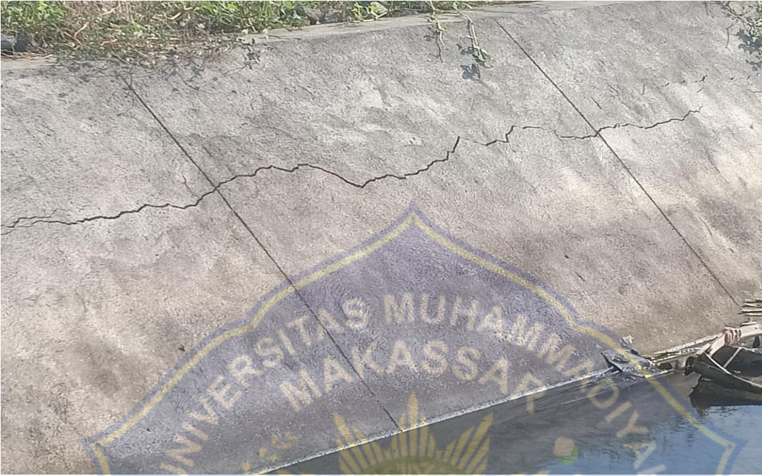
Gambar 5: Retak Pada Saluran Irigasi
