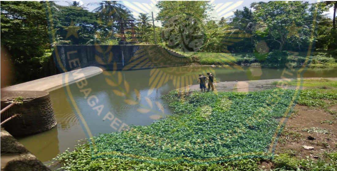
Gambar 2: Penumpukan Sedimen Pada Bendung Suplai Irigasi
