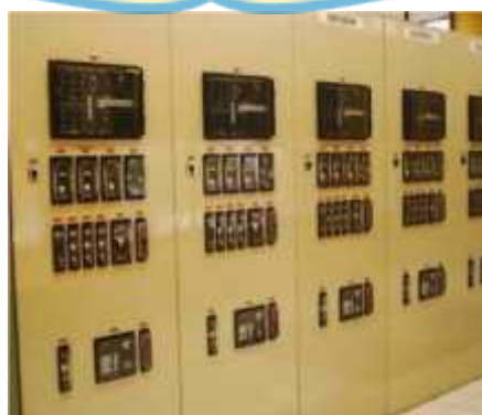
Gambar 2.22. Panel Kontrol Rele.
