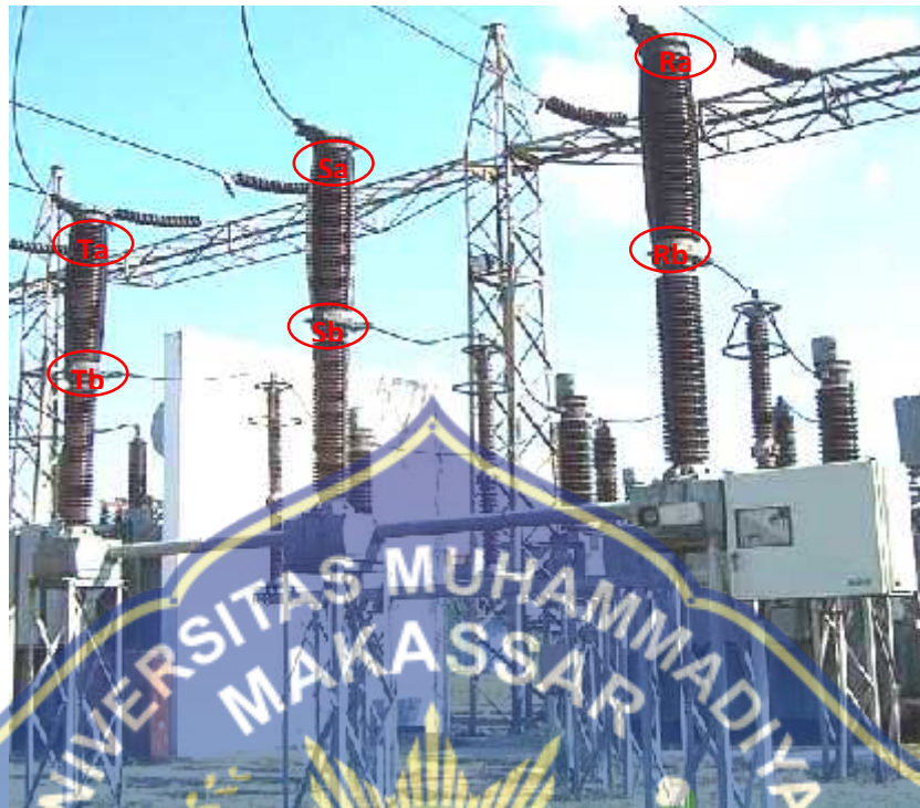
Gambar- 4.3. Terminal tempat pengukuran tahanan isolasi PMT
