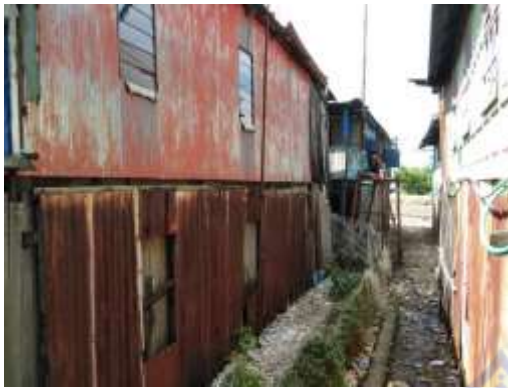
Kondisi rumah warga Sebelum dilakukan Pengecatan di Desa Bulu Cindea
