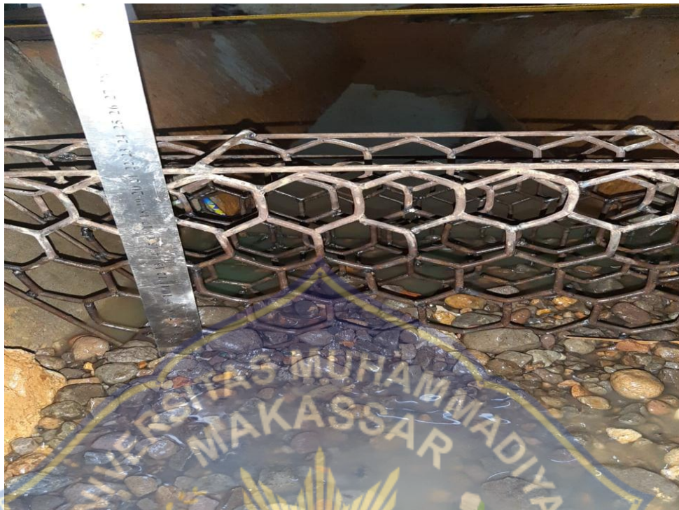
Bangunan Kisi Check Dam Hexagonal
